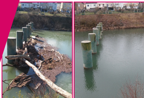
Avant-après : près de 25 m 3 de bois ont été sortis de l'écluse de Montcy-Notre-Dame par la Snef
